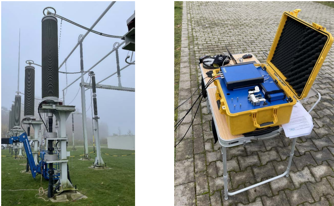
Bild 5 Messleitungen am Kabelendverschluss (links); Messsystem: Omicron FRANEO 800 (rechts)
