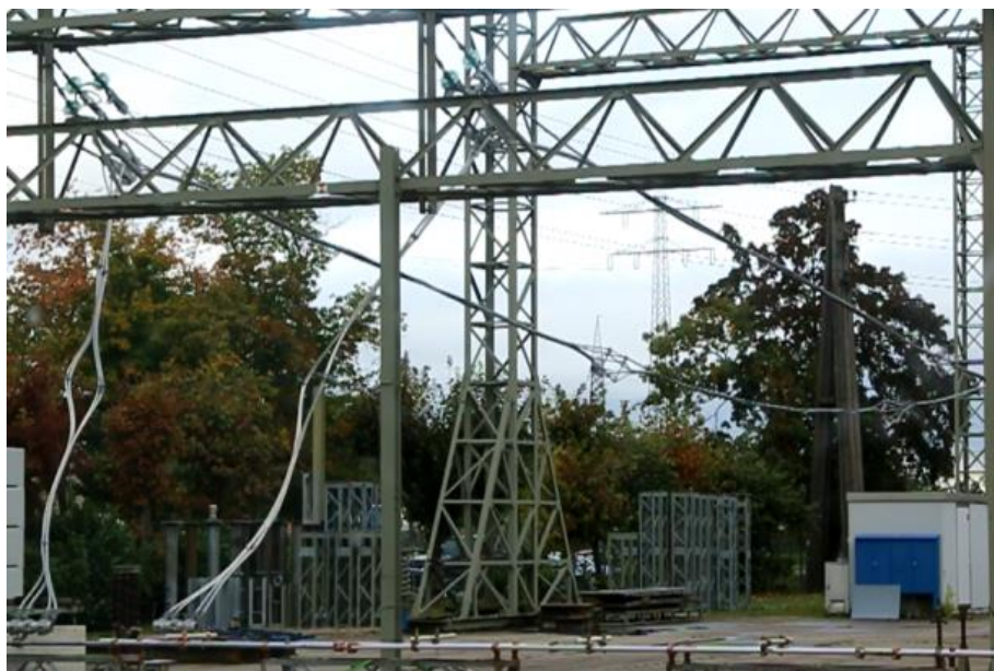
Bild 2 Kontraktion der Leiterbündel / Stahltragseile während der Kurzschlussstromprüfung
